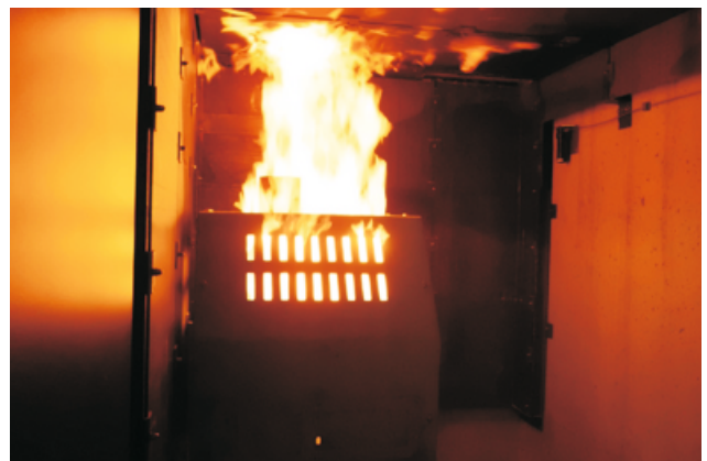
Feu de chaudière
