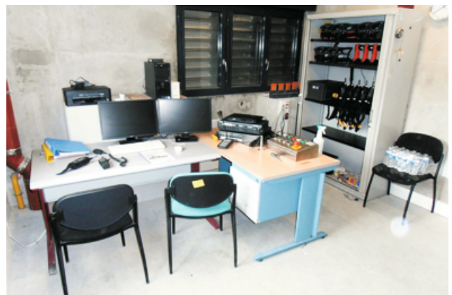
Salle de contrôle
